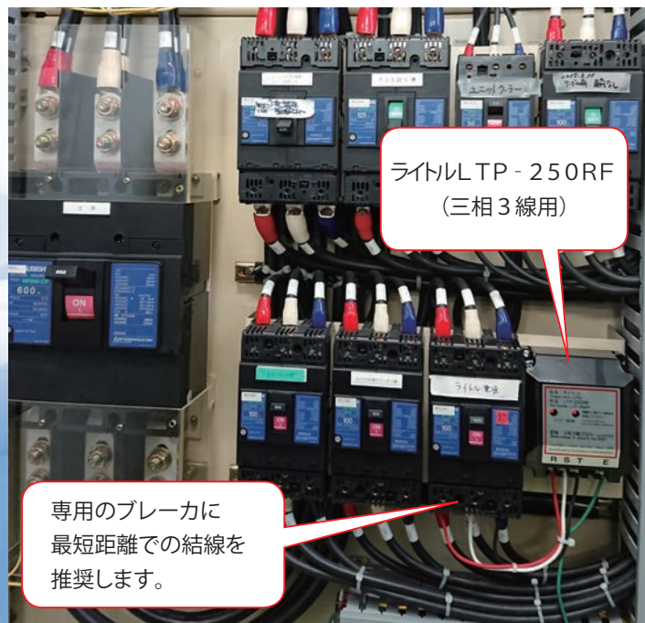
工場配電盤への設置例
